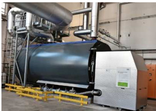
Zwei Gaskessel mit einer Wärmeleistung von jeweils 6000 kW decken die Spitzenlast an kalten Tagen ab.
