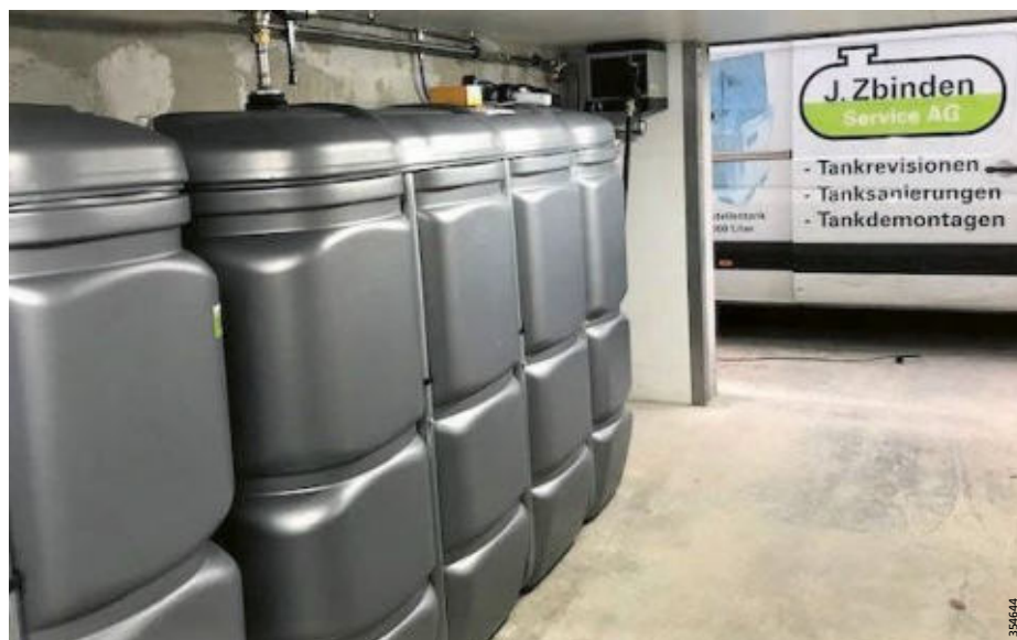
(Bild: Neue Dieselöl-Kleintankanlage 2 x 2000 Liter mit Kompaktsäule)
