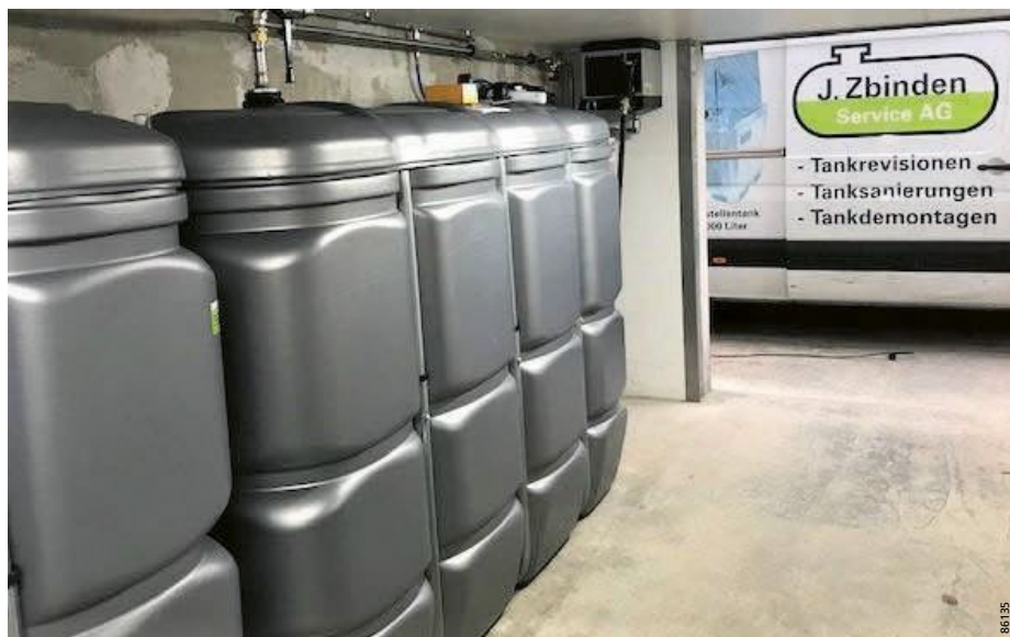
(Bild: Neue Dieselöl-Kleintankanlage 2 × 2000 Liter mit Kompaktsäule)
